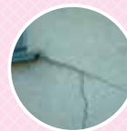
外壁ヒビ割れ
